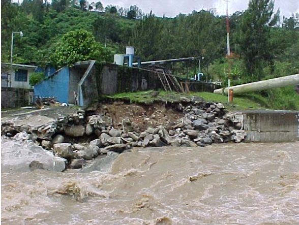
Foto 2. Daños en el paso del río Agua Caliente.
