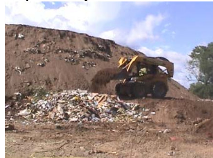
Cobertura de celda
