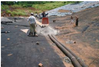
g. Drenaje de Lixiviados y tratamiento de estos
