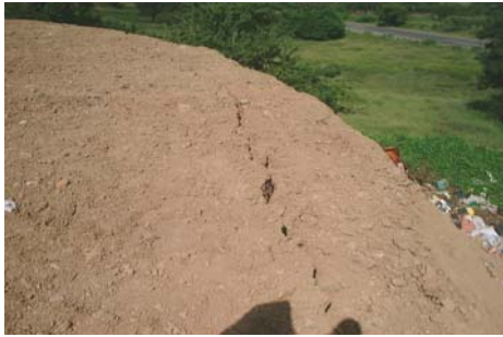
Grietas producto de la inestabilidad del método empleado lunes 20 de octubre 2003
