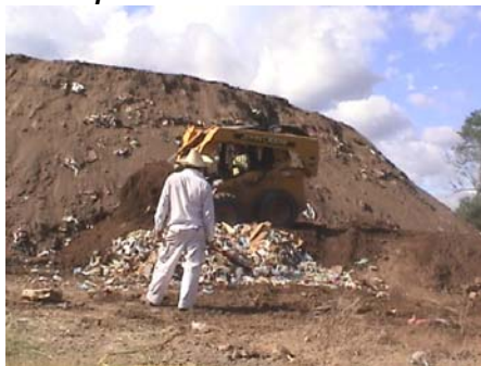
Cobertura de celda
